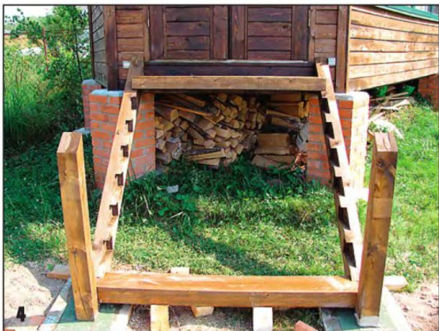
Правильность выставки основных элементов лестницы нужно проверить ещё раз после заливки фундамента.
