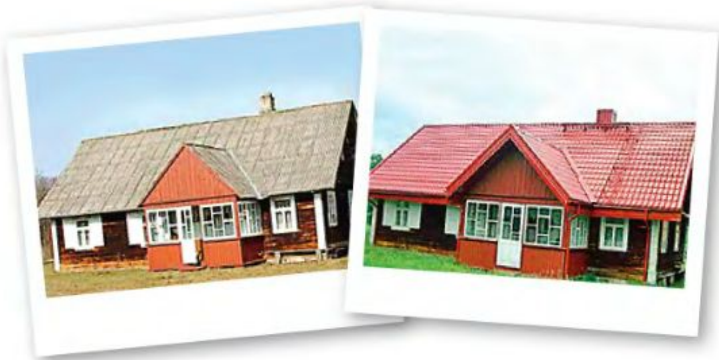
Достаточно было заменить кровлю из шифера на металлочерепицу, и дом чудесным образом преобразился.
